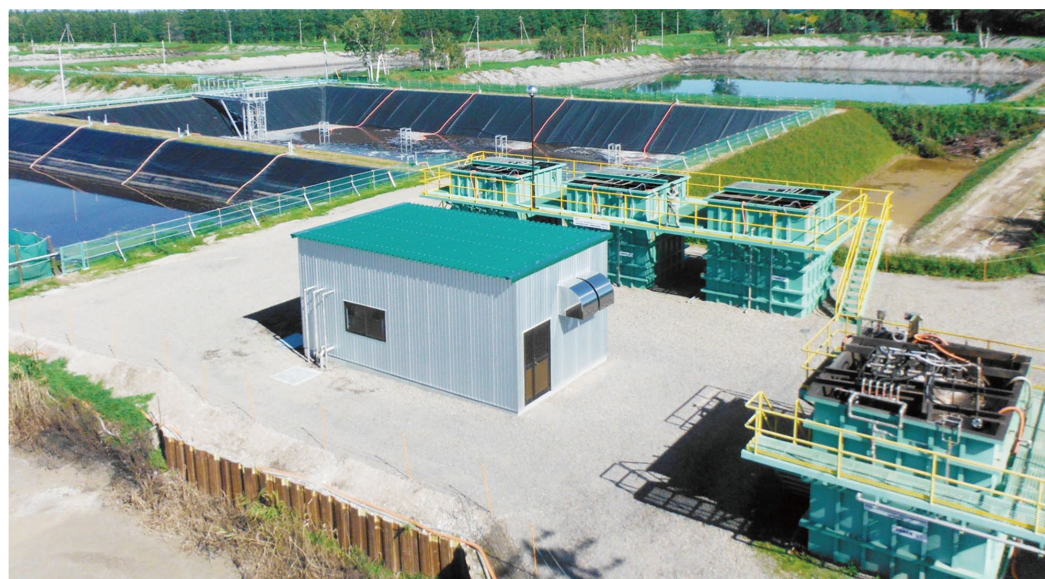
中央制御室と4か所の曝気槽
