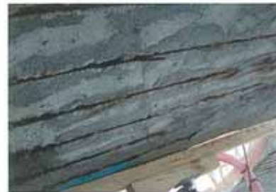
劣化したRCドーム
