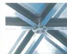
施工後2年経過したアルミドームの内面腐食は発生していない
