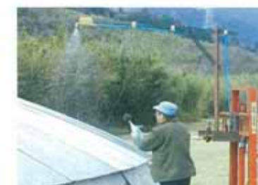
散水による騒音試験
