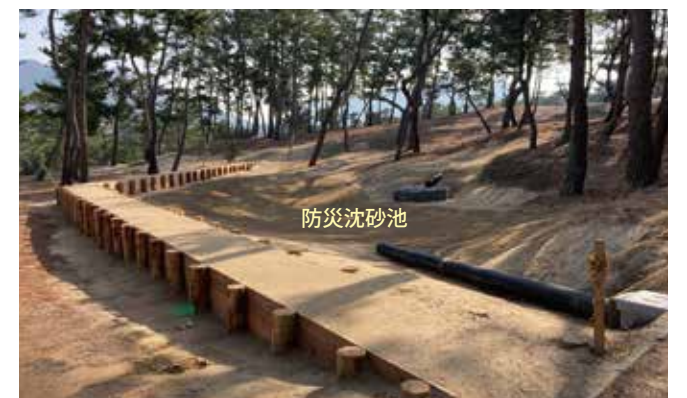
土砂流出防止用「防災沈砂池」
