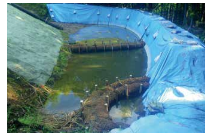
バイオログフィルターを備えた沈砂池で河川環境を保全
