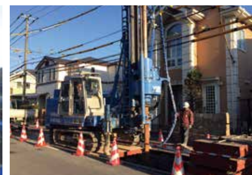
住宅地の液状化対策(千葉県)
