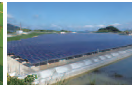
東芝上天草太陽光発電所 (熊本県)
