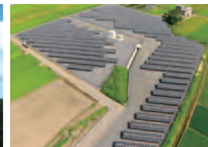
小泉太陽光発電所 (三重県)
