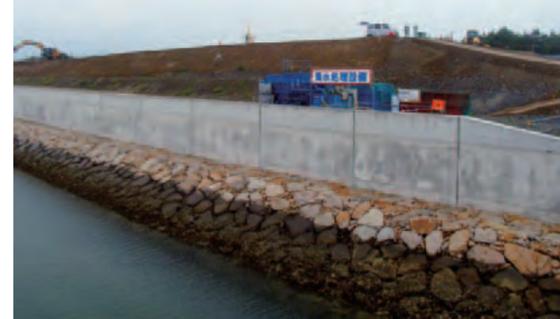
海を汚さない…濁水処理設備
