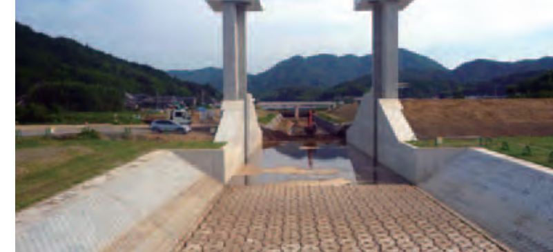
水門本体と堤外水路
