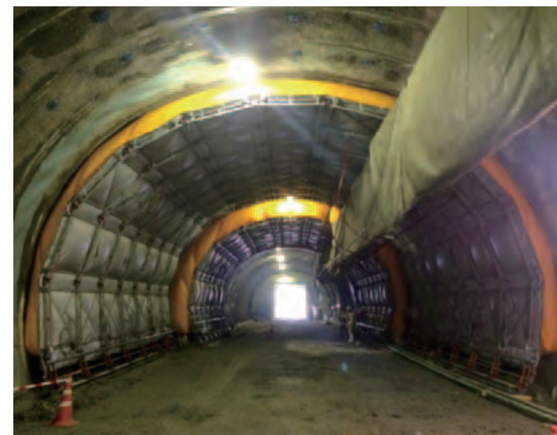
トンネルに設置された「ノイズカットバルーン」
