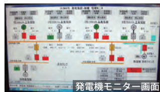
発電機モニター画面
