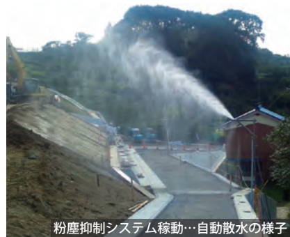
粉塵抑制システム稼動…自動散水の様子
