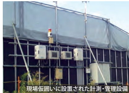
現場仮囲いに設置された計測・管理設備
