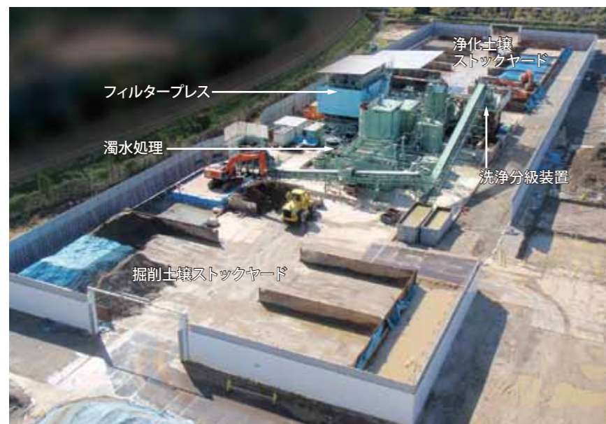
土壌洗浄プラント全景
