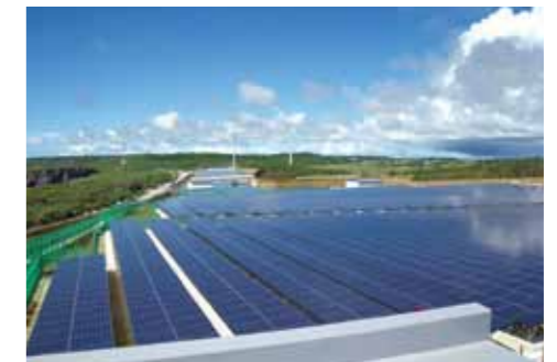
沖縄電力 宮古島メガソーラー実証研究設備
